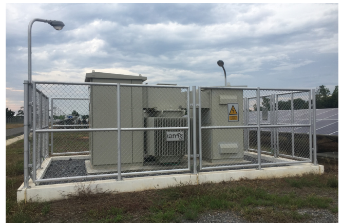
หม้อแปลงไฟฟ้า (Transformer)
