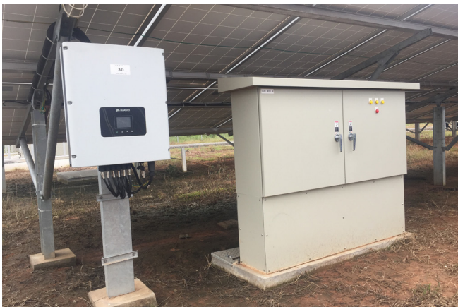
เครื่องแปลงกระแสไฟฟ้า (Inverter) / DC Combiner Box
