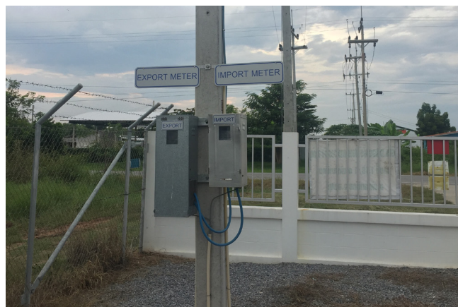
มิเตอร์วัดจำนวนหน่วยไฟฟ้า (Meter)
